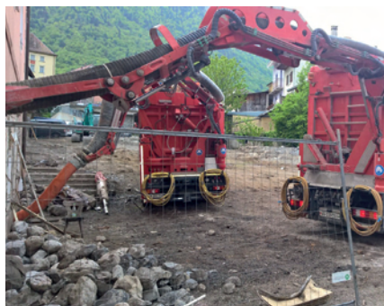
Einsatz nach Unwetter in Saint-Gingolph VS.
