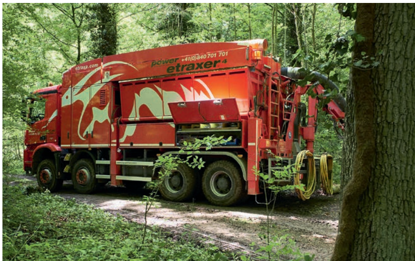
Mit moderne Saugbaggern wurde das alte Kies abgesaugt und neues Kies eingeblasen.
